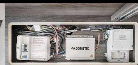
14 Moderne boardelektronica in de achterkant
